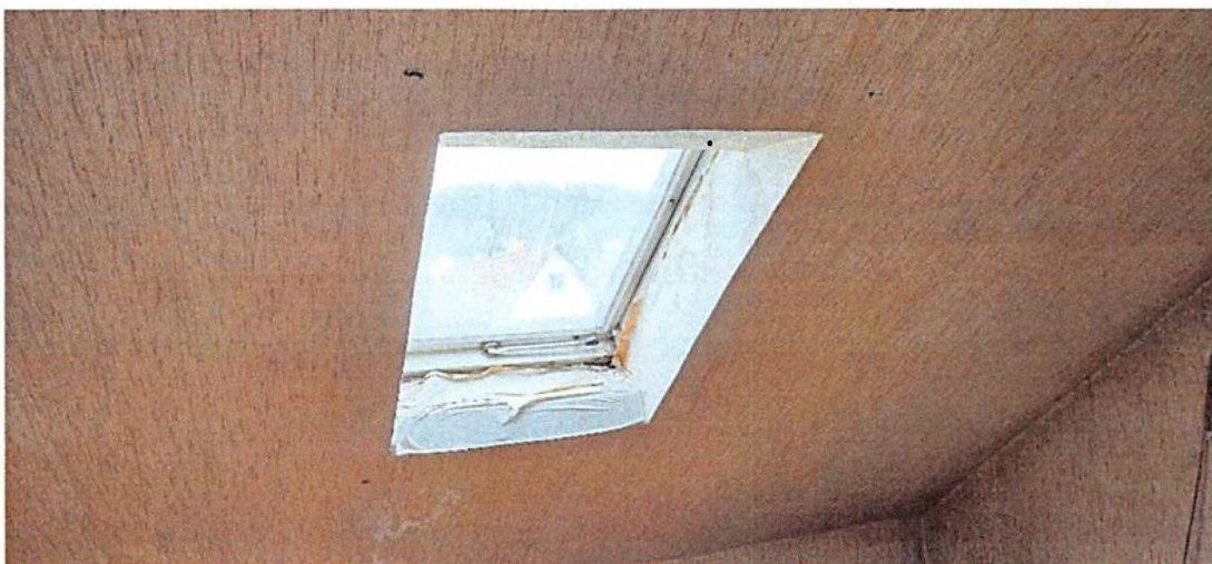
Feuchtezutritt am Dachliegefenster
