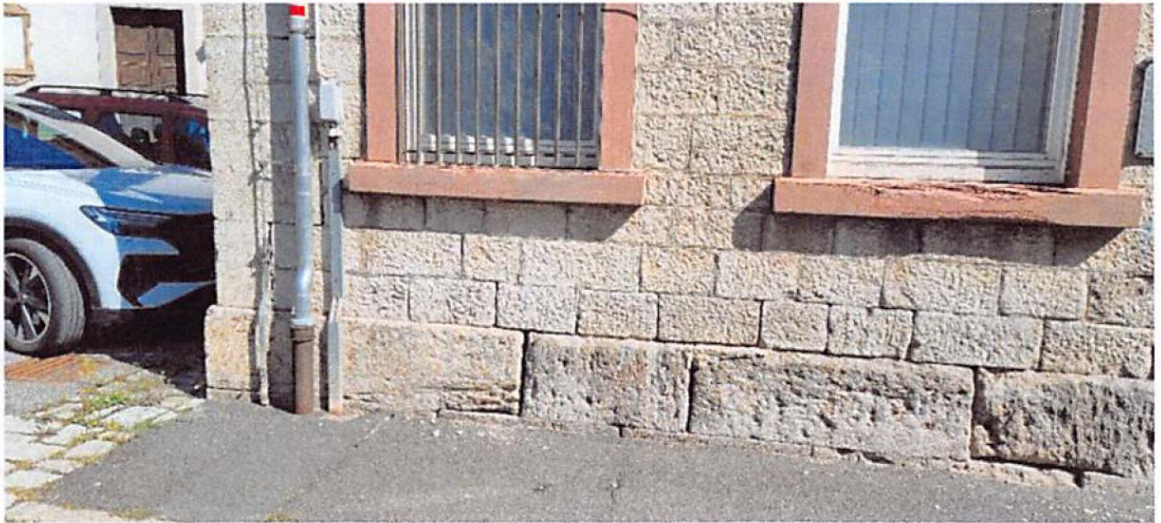
Rissverlauf im Sockelbereich am süd-westlichen Gebäudeeck
