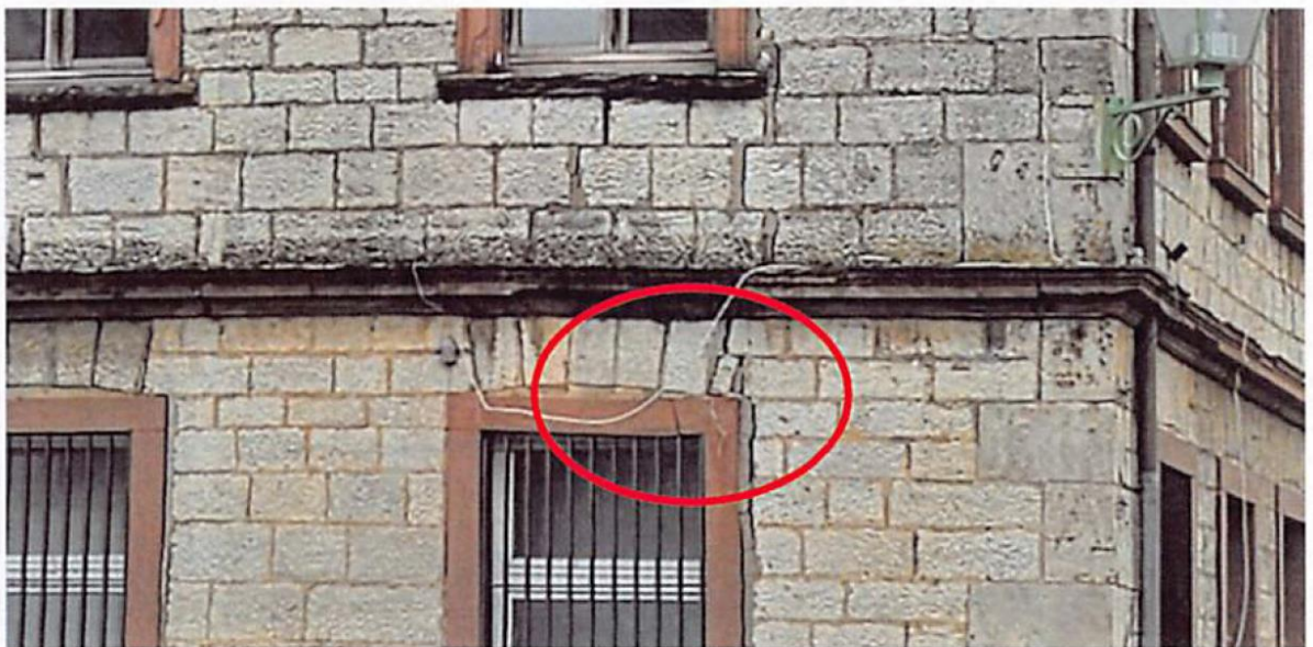
Gebrochenes Fenstergesims aufgrund Überlastung (Ausfall Fenstersturz)
