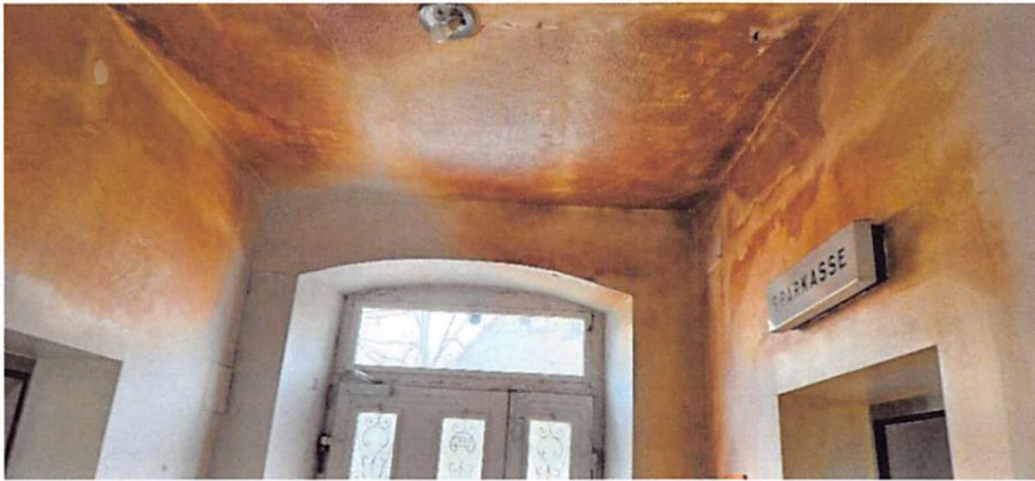
Verfärbungen im Eingangsbereich im Erdgeschoss infolge eines Ölschadens
