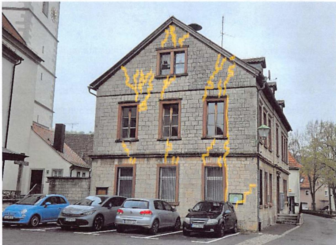
Hervorhebung der Rissverläufe am westlichen Giebel
