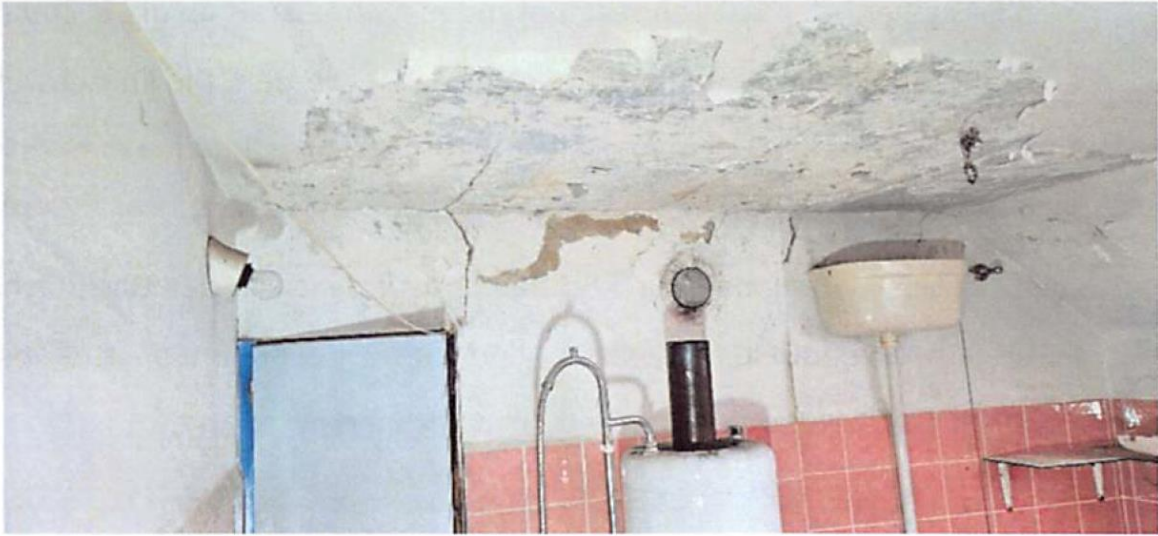
Putzschäden infolge Feuchtezutritt
