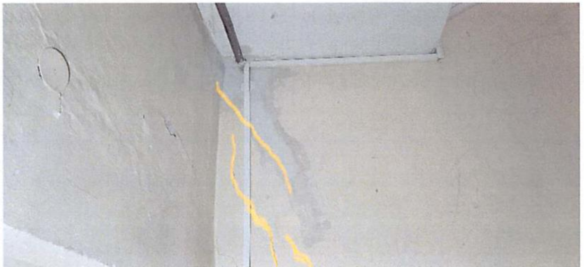
Neue Rissbildung im bereits verspachtelten Bereich
